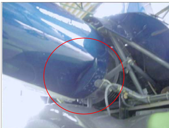
テール・コーン付け根 5時方向の座屈
